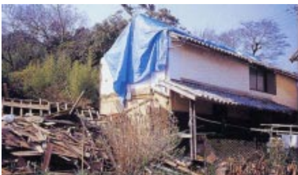
図3 震災で全壊した土蔵(左)と半壊した土蔵(右) (1997.3.8 淡路島西淡町)
